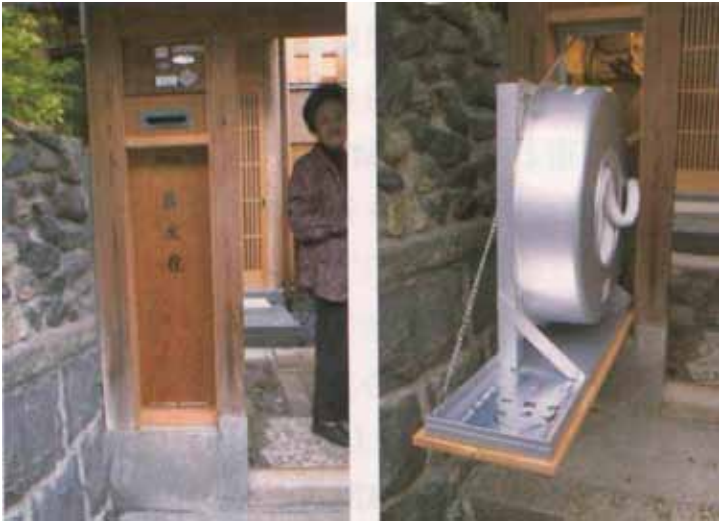
Resim 4: Tarihi kent merkezlerinde ikamet edenlerin yangına hızlı müdahalesi için tesis edilmiş yangın söndürme sistemi. (Kyoto, Japonya)
